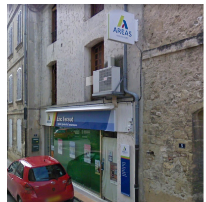
Enseigne drapeau trop haute et climatiseur mal implanté
