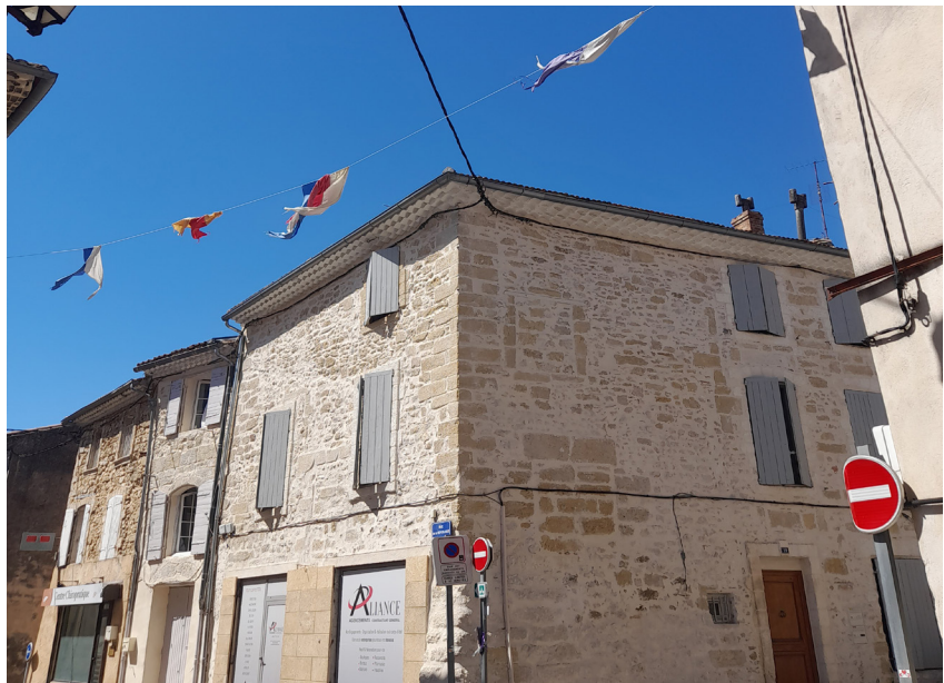
Fenêtres bouchées Rue de la République
